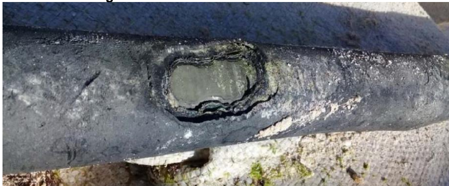
Imagen VII.3 Daño en la Fase C del conductor
