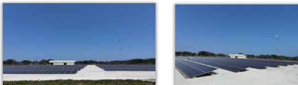
Granja Solar “Santa María del Mar”, en el estado de Oaxaca.
