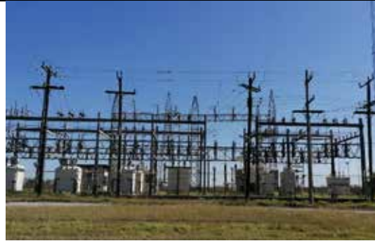
Ilustración 3. S. E. San Fernando
