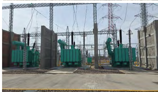
Ilustración 9. Banco 3 de 230 kV de 100 MVA
