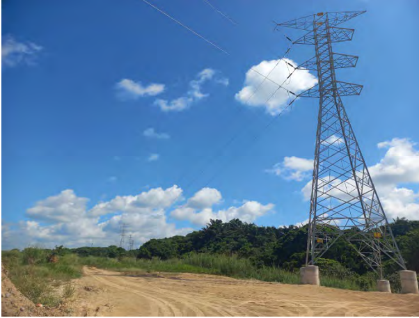
Fotografía: Trabajos de modificación de Líneas de Transmisión, en alta tensión, al interior del Puerto de Coatzacoalcos (ASIPONA)
