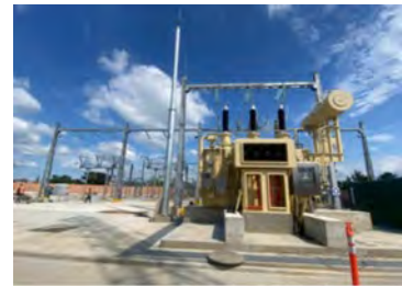
S.E. Gaviotas Bco.1 +1.8 MVAR
