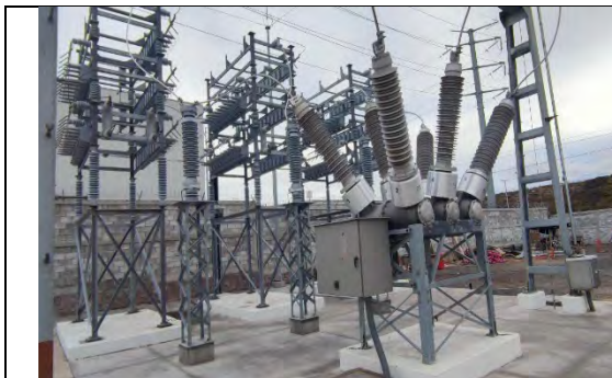
Ilustración 10. Banco de capacitores SE Parque Innovación
