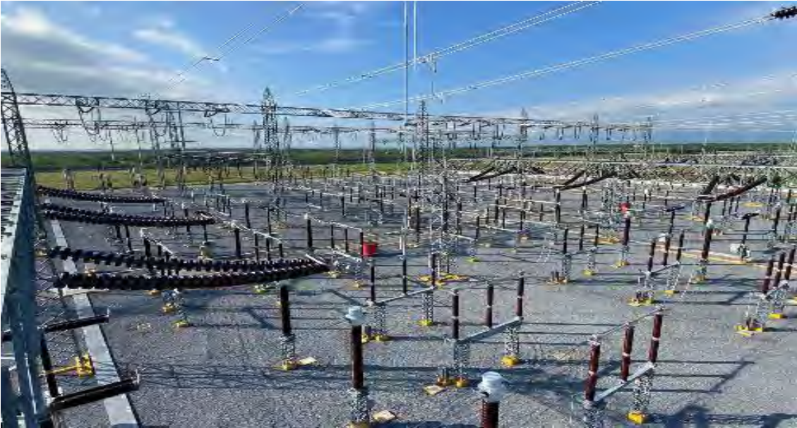
Fotografía: Subestación Regiomontano
