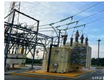
S.E. Valle Alto Banco 1 (Sust.)
