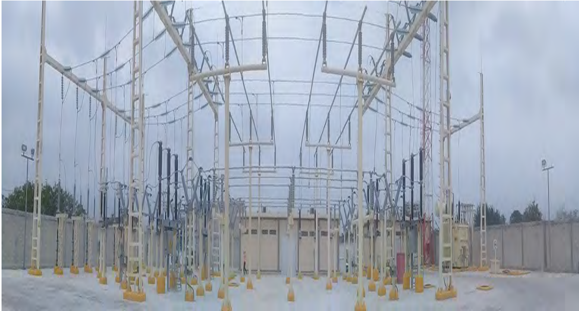
Fotografía: Subestación de Distribución Elena Banco 1 + MVAR
