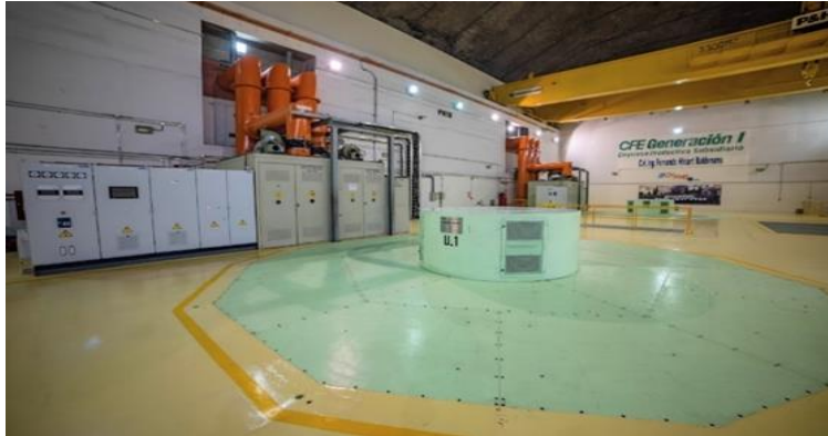
Unidades de la C.H. Ing. Fernando Hiriart Balderrama.
