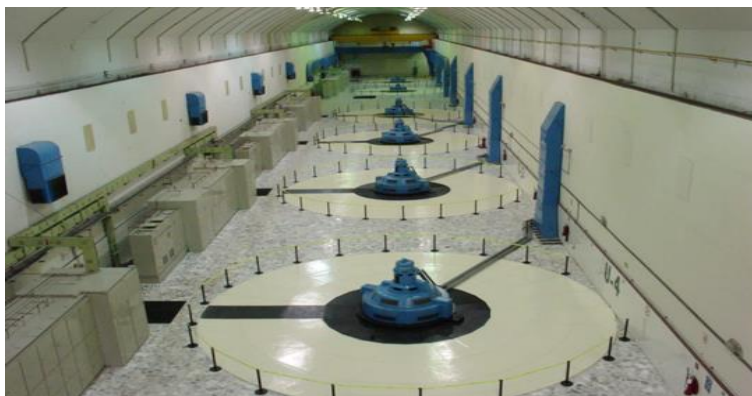
Casa de Maquinas C.H. Infiernillo
