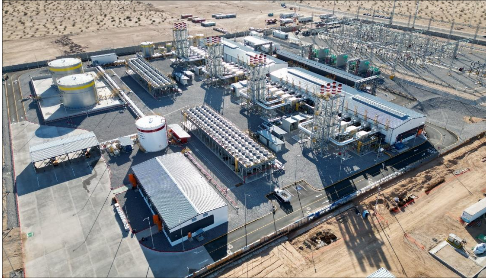
Imagen 10. Central de Combustión Interna Altar (Parque Industrial), en operación desde junio 2023.
